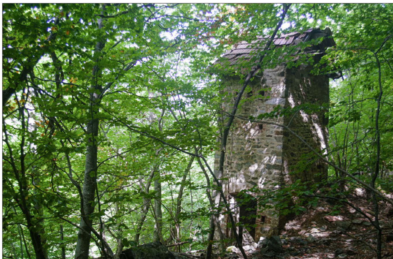
Fig. 12 : Transformateur électrique de Roca Gelera, Valmanya — Transformador elèctric de Roca Gelera, Vallmanya Photo : R. Molina, 2019 / SMC GS
